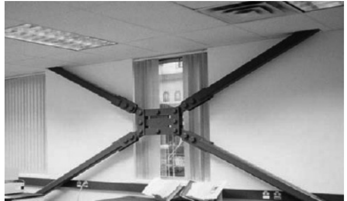
شکل ۱: میراگر اصطکاکی در یک ساختمان فولادی
